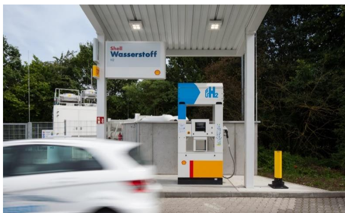
Abbildung 11: Wasserstoff-Tankstelle der H2Mobility [51]
